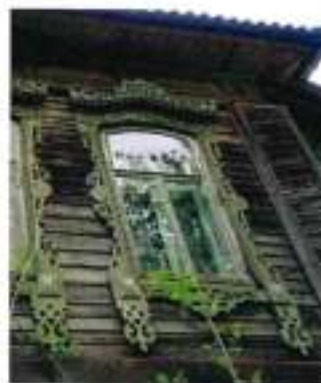
Фото 1. Наличник окна второго этажа западного фасада
